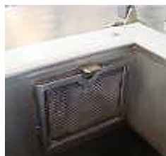
Unidade de filtro
