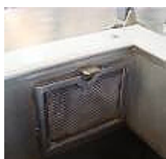
Unidade de filtro
