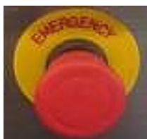
Botão de emergência
